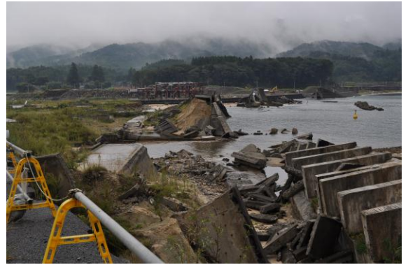
津波で破壊された防潮堤(山田町船越)
